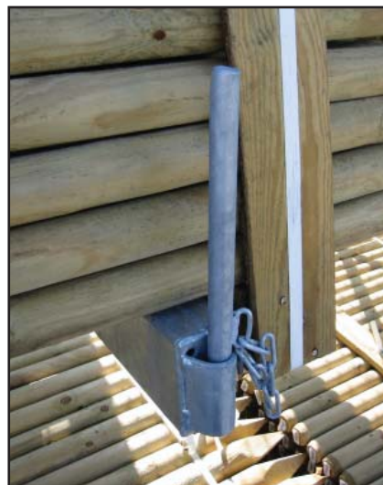
Gren med løst endestop.
